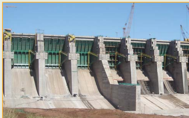
Imagem 05: Usina Hidrelétrica Foz de Chapecó, Chapecó - SC Devido aos grandes esforços é importante a protensão nos pilares e vigas dos vertedouros das UHE.
