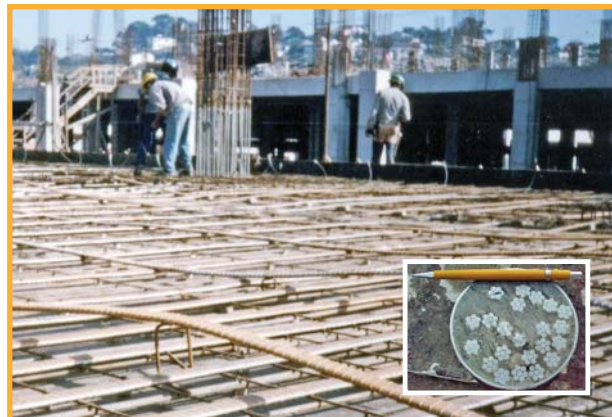
Imagem 09: Execução de laje com protensão aderente. No detalhe, seção transversal de um corpo de prova de ensaio com aderência.
